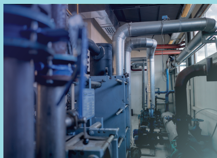
На фото: Термоізоляція трубопроводів лід-води на ТОВ «Молочна компанія Галичина»
